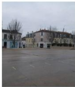
une surface dégradée et complexe (emmarchements, inclinaison)
